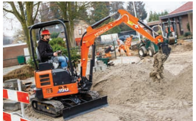
Der kleine Heckschwenkradius ist ideal für Arbeiten unter beengten Platzverhältnissen.
